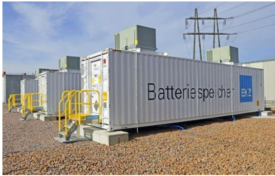
Trockenbatterie in Volketswil
